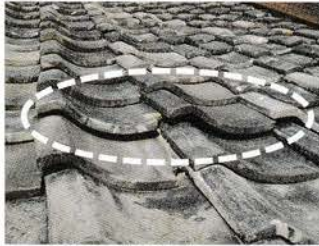
瓦に浮き上がりが生じている
