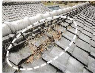
瓦がずり下がり、葺き土に植物がみられる
